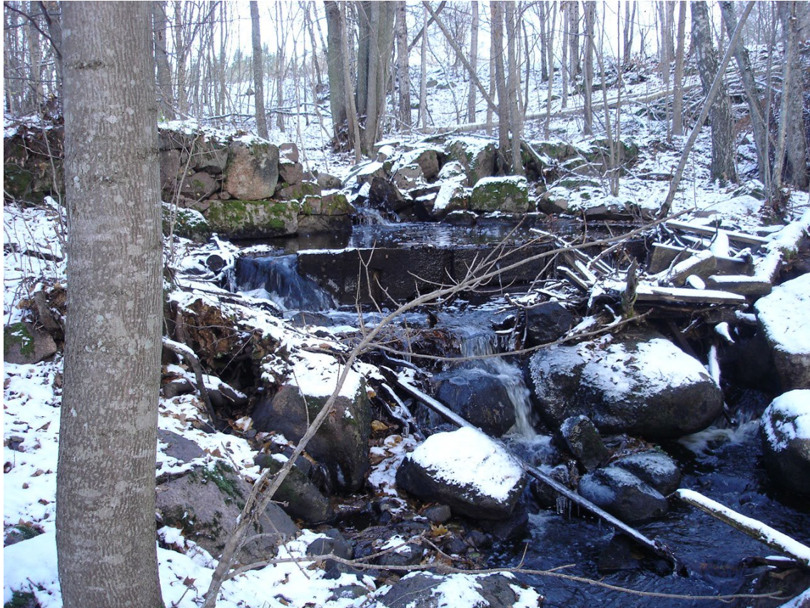
Vandringshinder i Dammbäcken bestående av en betongtröskel nedströms en raserad stendamm.
