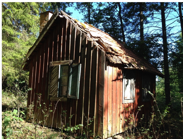
Mindre byggnad i dåligt skick inom skötselområde 6.
