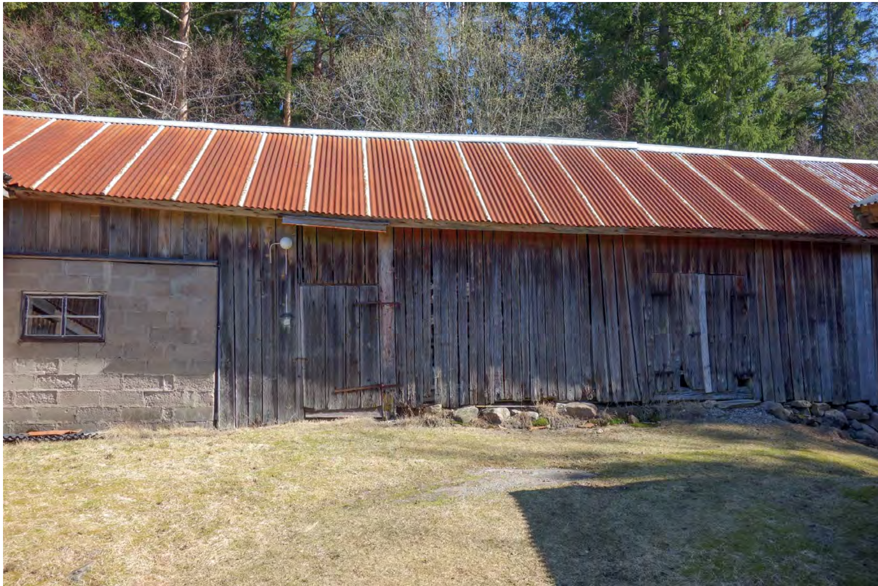
Västra fasaden som till stor del har panel av halvklovor. Taket är här täckning av sinuskorrugerad plåt. Galvaniseringen har till stor del släppts. (Fredriksson arkitektkontor).
