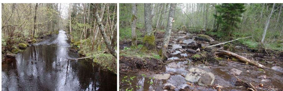
Figur 12. Biotopvård på strömsträcka precis nedströms gångbro vid badplatsen vid Strålsnäs 2016. Överst återförande av sten, block och död ved samt lekgrus. Nederst visas till vänster sträckan före åtgärd och till höger direkt efter åtgärd.
