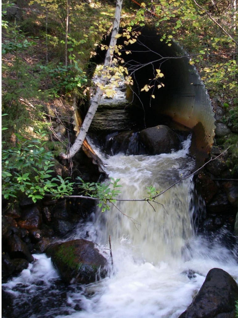
Foto 4. Felaktigt utformad vägtrumma som åtgärdats.
