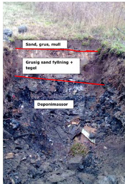
Täcksiktet på Klagshamnsdeponin är stundvis mycket tunt. Bild från Ramböll (2015).
