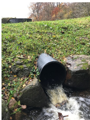
Figur 7 Nuvarande utlopp från Klåverödsdammen till Kvärkabäcken utgör ett vandringshinder för många vattenlevande organismer.
