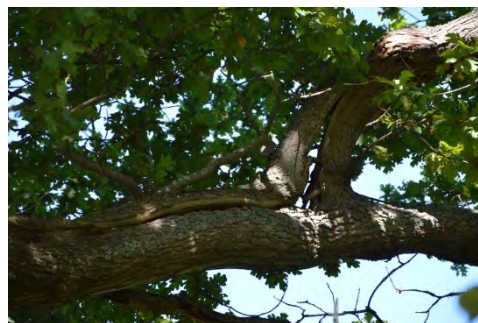
Foto av sprickan
