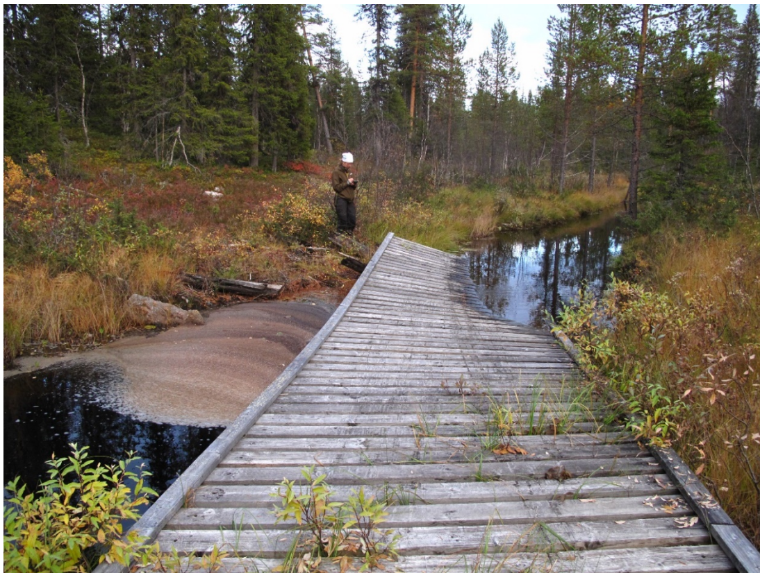
Foto 5: Bron över Vitbäcken nedströms flottningsdammen var i dåligt skick 2012. Foto: Frédéric Forsmark.
