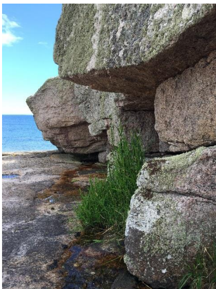
Figur 8. Vittrade sprickplan vid Vindhalla. Foto: K. Olsson, 2016.
