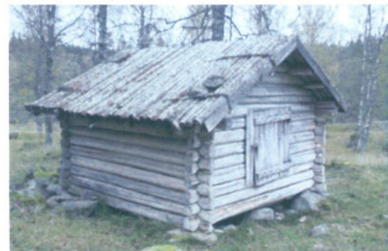
Ladans fasad mot öster och norr. Utbordsbräda och utbordskrok på långsidan är helt borta, med risk för att farjstören rasar ned. Foto: Värmlands Museum, Monica Björklund.
