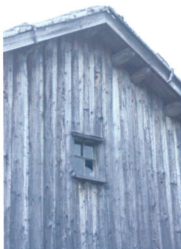
Västra fasadens gavelfönster med skadat fönsterglas. Foto: Värmlands Museum, Monica Björklund.
