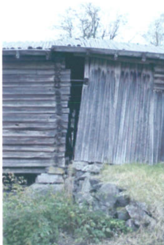
Övergången mellan ladugård och loge mot söder. Sättningskador har gjort att stomme och tak kalvat isär. Foto: Värmlands Museum, Monica Björklund.
