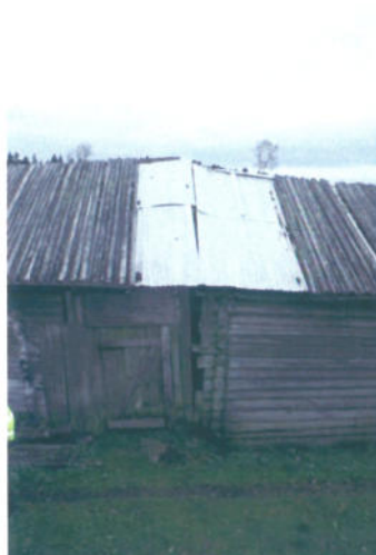
Övergången mellan ladugård och loge mot norr. Sättningskador har gjort att stomme och tak kalvat isär. Farjstörar, utbordskrok och utbordsbrädan har rasat ned. Åtgärder planeras under 2010. Foto: Värmlands Museum, Monica Björklund.
