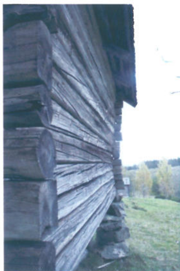
Logens västra fasad, delar av stommen har förskjutits i sidled. Foto: Värmlands Museum, Monica Björklund.
