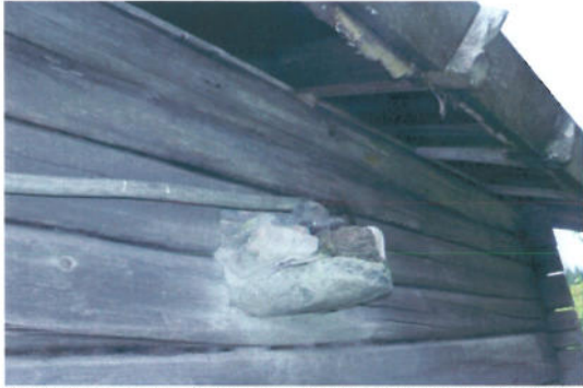
Rökstugans norra vägg, igensatt hål där rör till kamin löpt ut. Foto: Värmlands Museum, Monica Björklund.
