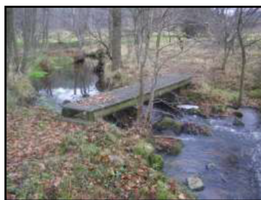
Mindre bro över Julebodaån, Hörrodsån. Bron bör kompletteras med ett räcke på den ena sidan
