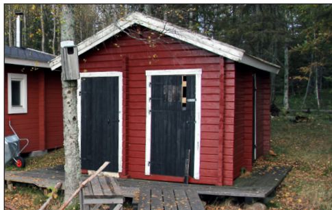
Hus 1 ligger bredvid bastun nära gästbryggan. Byggnaden har funktioner för vedförvaring, två torrdass och sopförvaring. Sopor förväntas besökare numera ta med sig hem och utrymmet är låst och används som förråd av skötselansvarig. Dörren är trasig.
